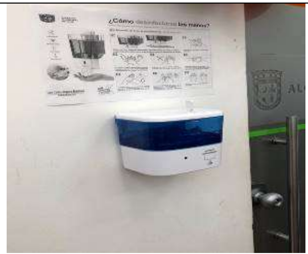
Instalación de dispensadores de Gel antibacterial, con sensor.
